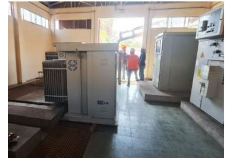
Conservación Salas Eléctricas
